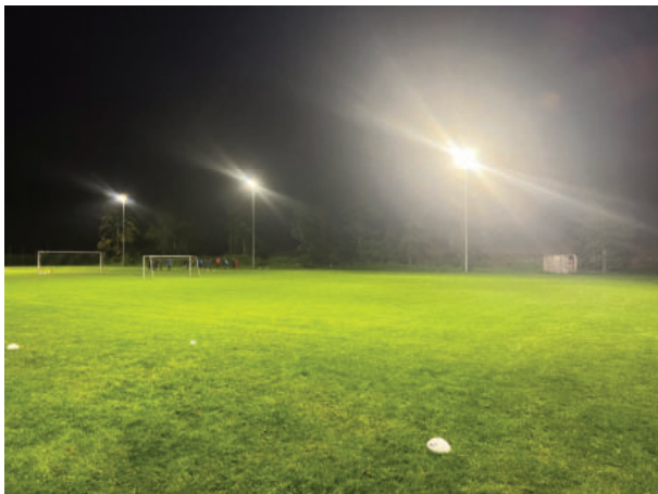
Trainingsplatz (Bild) und Hauptplatz wurden mit LED-Flutlichtern ausgestattet
