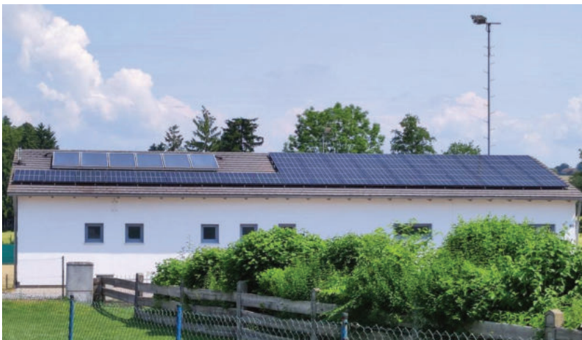
PV ergänzt die Solarthermieanlage auf dem Dach des Vereinsheims
